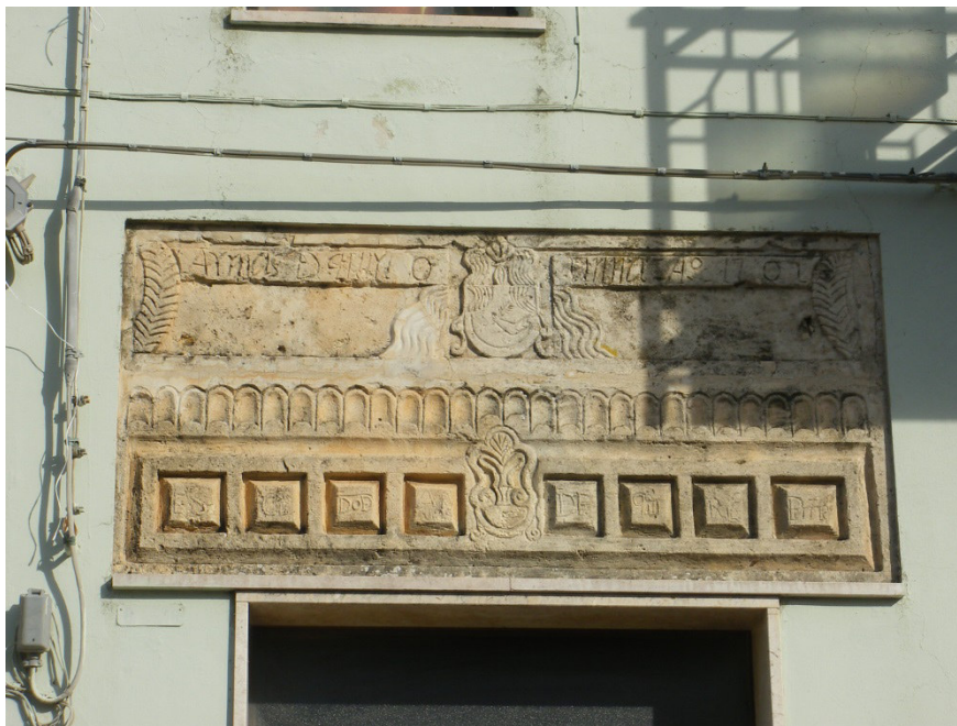
Architrave istoriata del 1707 con stemma centrale e pregiato bassorilievo, inserita nella facciata della unità edilizia AD19
